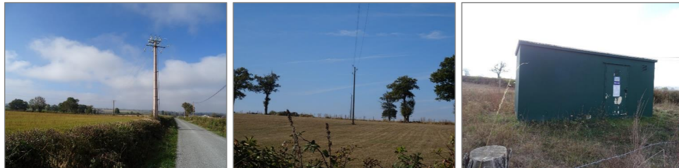
Photographie 28 : Lignes électriques HTA traversant la ZIP et poste de livraison du parc existant (Source : ENCIS Environnement)
